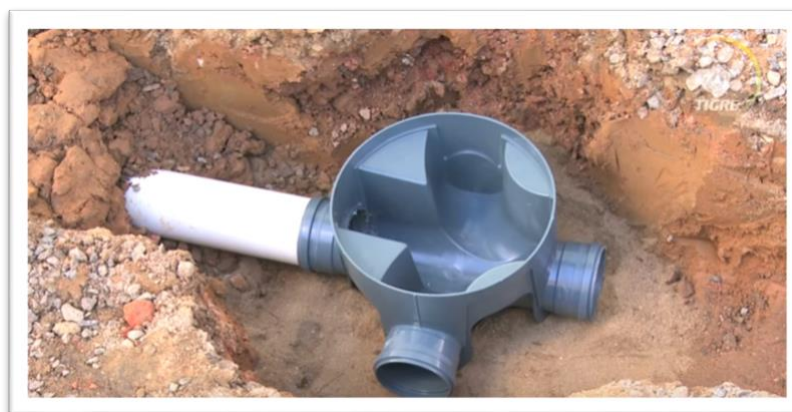
Figura 18 – Detalhe da instalação de uma Caixa de Passagem/ Inspeção propostas pela SAMENCO
